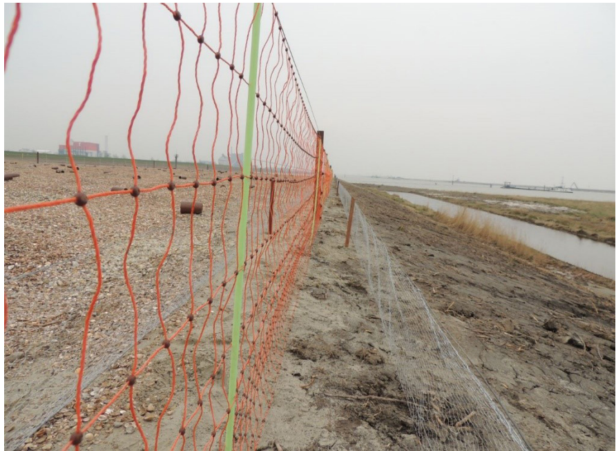
Foto 7. Detail elektrisch raster op het broedeiland van de autopier van Oterdum (Delfzijl), 13 april 2014. Vlakke ondergrond met strak sluitend raster onderaan duidelijk zichtbaar. Bovenzijde raster voorzien van spandraad wat het raster strak en recht houdt.
