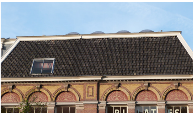
Meerdere nestingen met gierzwaluwpoep bij het bovenste boeiboord van het dak.
