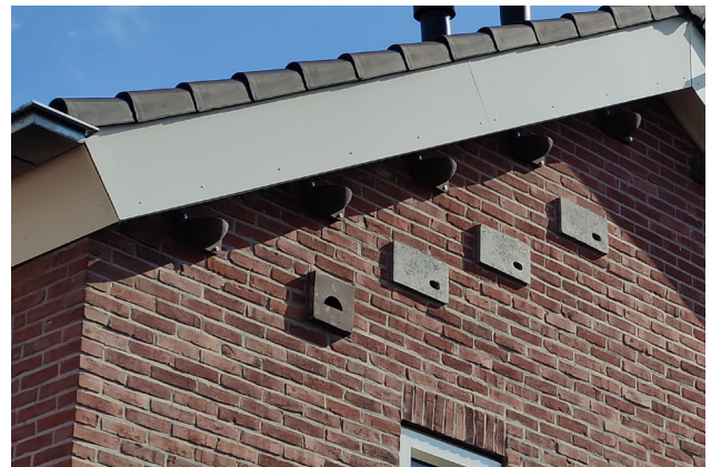
Neststenen voor de Gierzwaluw in de gevel.
