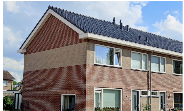
Nestvoorzieningen voor de Huismus zijn aangebracht in de vorm van voorzieningen in de dakgootbekisting (ISO-bouw).
